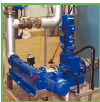
Pompe de transfert et broyeur pour déchets biodégradables
