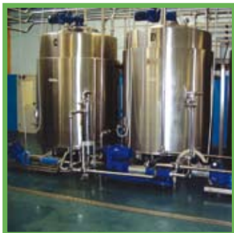
Pompes sanitaires transférant du miel
