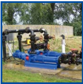
某污水厂输送污泥
